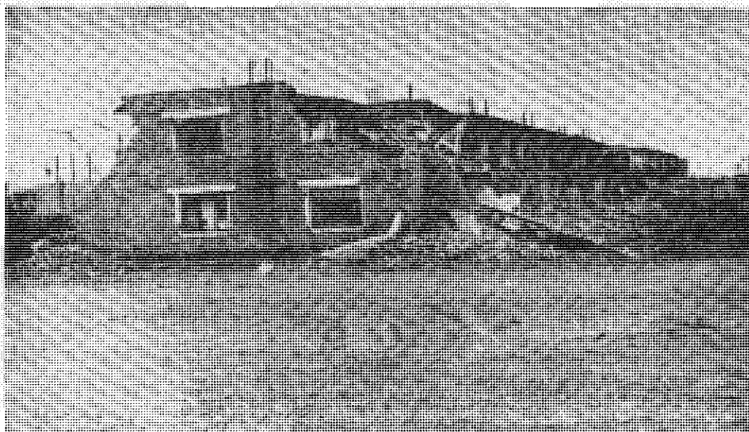
Рис. 13. Характер разрушения зданий в пос. Газли от землетрясения 17 мая 1976 г.
